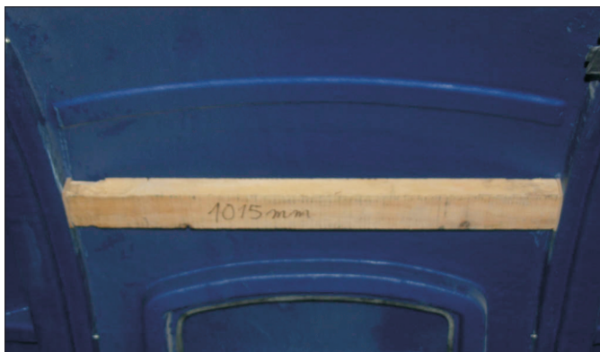
Drewniana rozpórka poprawiająca geometrię kopuły
